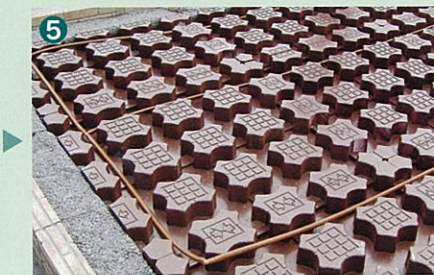
フレキシブル排水促進材の設置 自動灌水ホースの敷設
