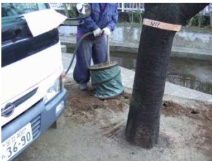
①エアスコップでの縦穴掘り取り作業。周りに飛ばないように飛散防止しながら施工する。
